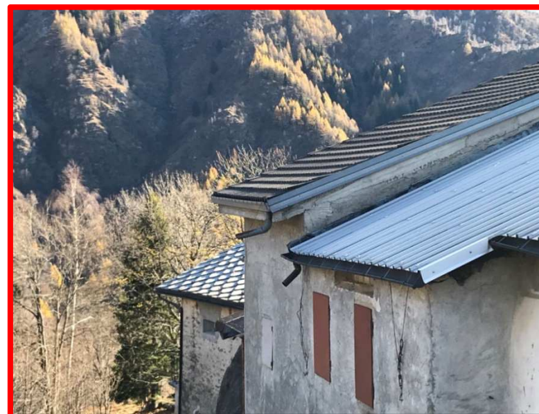
Figura 25: manto in lamiera grecata sconsigliato
