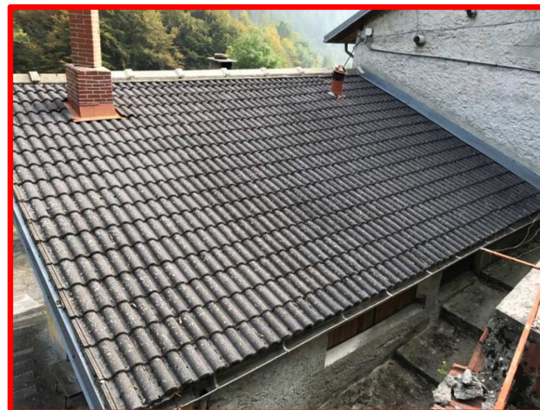
Figura 24: manto in laterocemento sconsigliato
