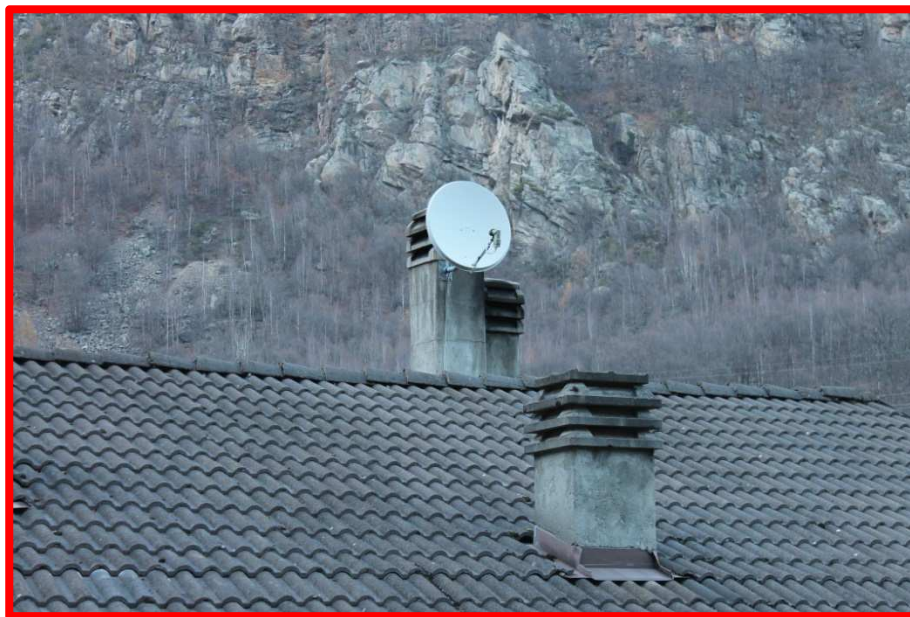
Figura 27: comignoli in calcestruzzo sconsigliato
