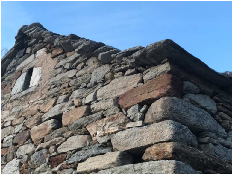
Figura 7: lose poggianti su muro perimetrale Località Alpe Buri –Settimo Vittone
